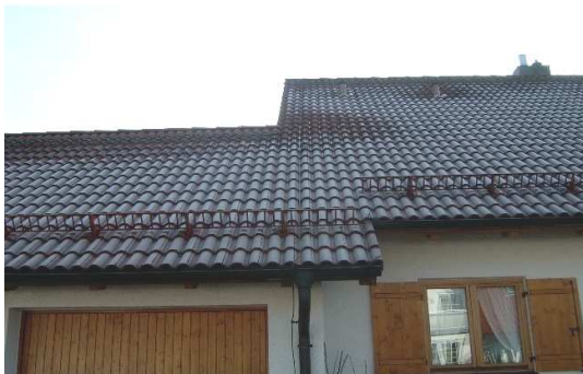
06.02.2009: foto van de noordzijde. Beoordeling: geen mos of korstmos, alleen vervuiling door luchtverontreiniging.
